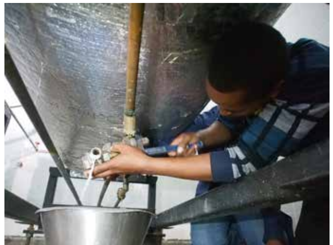
4-12-2019. Eén van de technici demonteert de defecte condenspot.
